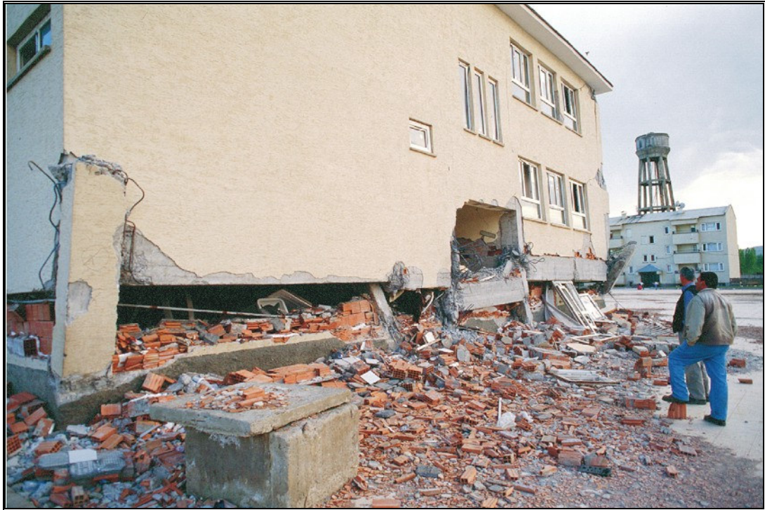
Şekil 26. Çeltiksuyu YİBO dersane binasının gördüğü hasara karşın, arka planda az hasarlı lojman binası ve hiç hasar görmeyen su deposu.
